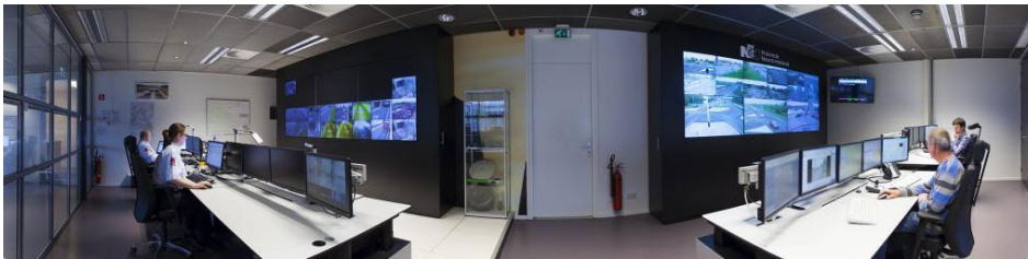
Figuur 2.1. Huidige situatie tunnel- en verkeersmanagementcentrale Hoofddorp
